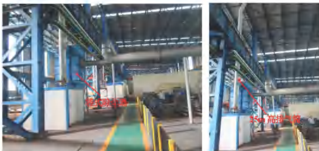
图 4-1 精整 1#探伤线抛丸废气治理措施落实情况
