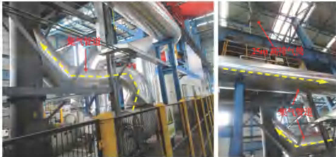
图 4-5 1#棒材连续退火炉废气治理措施落实情况
