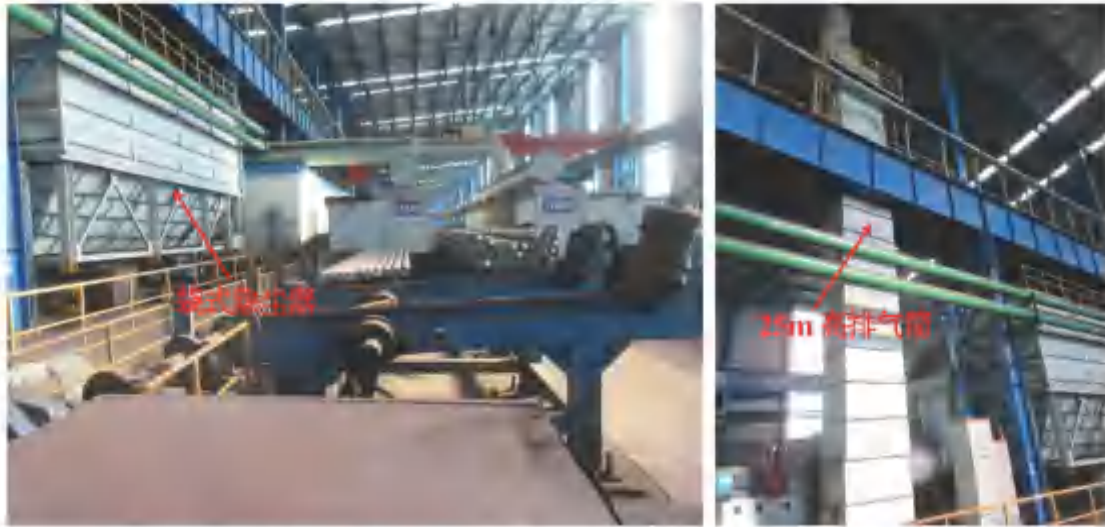
图 4-4 精整 1#、2#修磨线修磨废气治理措施落实情况
