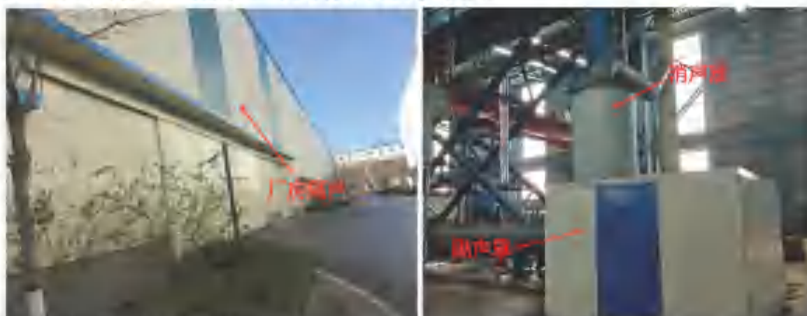
图 4-7 噪声治理设施落实情况
